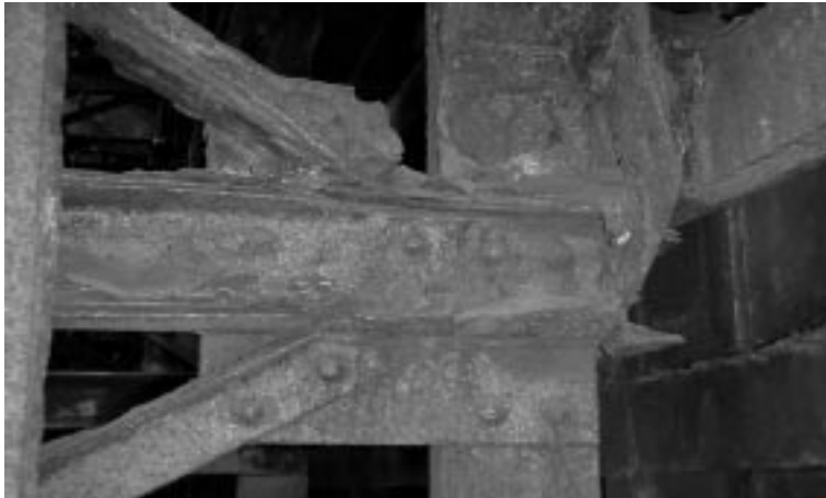
Foto 3.10.1: Stark korrodiertes Knotenblech mit Aufblätterungen am Traggerüst des Kohlenbunkers
