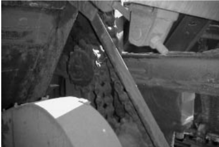
Foto 2.5.4: Kettengetriebe mit Spannvorrichtung (oben im Vordergrund: fedrige Anpressung der oberen Rutschbleche an die Riffelwalze)
