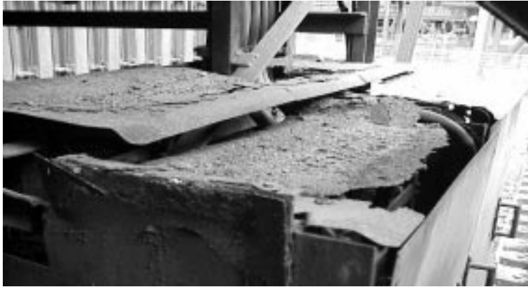
Foto 3.10.7: Unterschied im Korrosionszustand beregneter/unberegneter Teile
