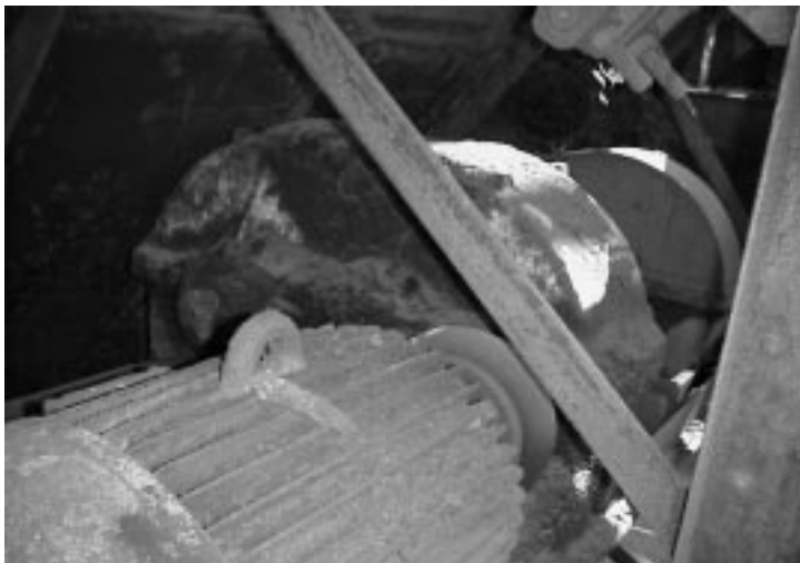
Foto 2.5.3: Antriebsmotor mit zwei Getrieben zum Antrieb der Riffelwalze
