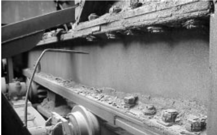
Foto 2.4.4: Blechzeiger neben Ausdrückstange (im Hintergrund: zweigeteilte Auflagerrolle, Gleitschuh und Antriebsritzel)
