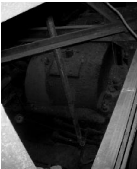
Foto 2.4.3: Schaltgetriebe Ausdrückstange und Einrückvorrichtung (im Vordergrund: Schaltstange)
