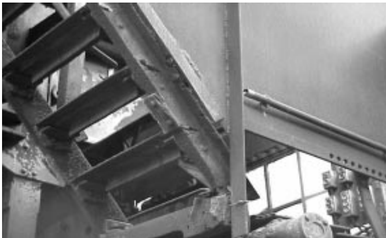
Foto 3.10.2: Durchrostungen an Aufgang zu Kohlenbunker
