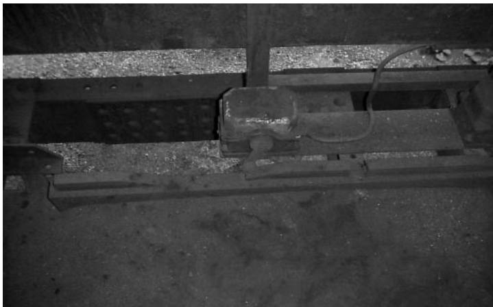
Foto 2.2.14: Steuerkurve mit Schaltern zum Steuern der Querfahrbewegung
