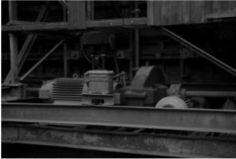
Foto 2.2.1: Antriebe Längs- und Querverfahren (linker Motor: Längsverfahren, rechter Motor: Querverfahren, im Vordergrund: Magnet zur Längsfahrbremse, im Hintergrund: Getriebe Längsfahrt)
