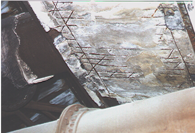
Foto 1.4: Freiliegen der Armierung und Übergangsbereich Blechjalousien und Dachfläche 1
