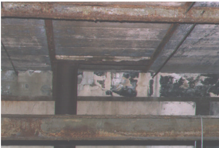
Foto 3.3: Dachfläche 1; in hinterem Bereich Abplatzungen
