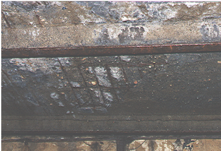
Foto 2.9: Freiliegen der Armierung
