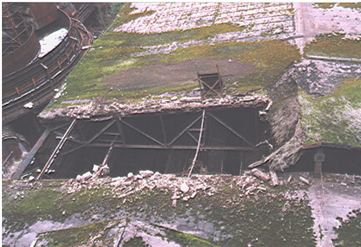
Foto 4.2 Ansicht Lichthaube eingestürzt (Januar 1999)
