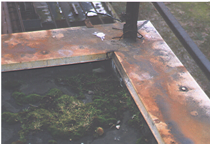
Foto 6.2: Ablauf zum Fallrohr
