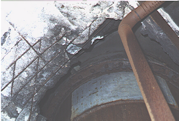
Foto 1.3: Freiliegen der Armierung (Dachfläche 7b) und Blick auf Blechbühne (Dachfläche 8)
