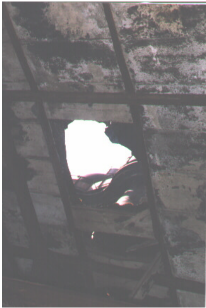
Foto 4.16: Innenansicht Löcher in Dach
