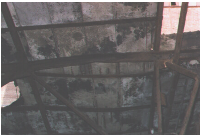
Foto 4.17: Durchhang in hochofenseitiger Dachfläche (vor Kalkbrecher)
