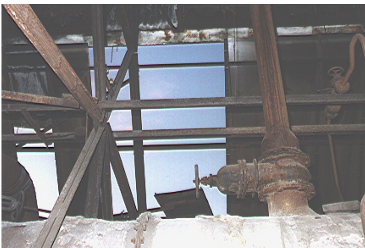
Foto 2.4: Fehlende Fenster an Dachfläche 7
