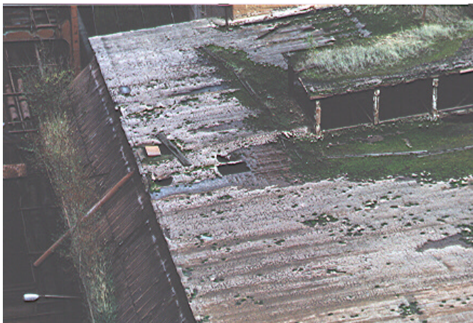
Foto 4.5: Schäden neben Lichthaube
