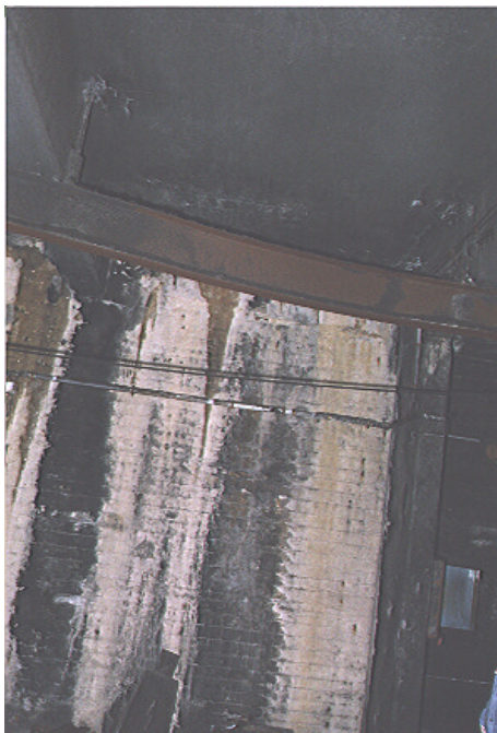
Foto 6.5: Durchnässung Wand (aufgrund Undichtigkeiten Zentraldach)
