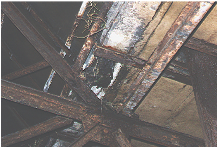
Foto 2.6: Wurzelduchtritt und Durchfeuchtung aufgrund Schmutzkeil aus Foto 2.5
