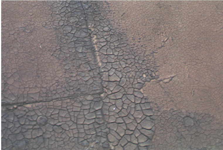
Foto 1.6: Versprödetes Bitumen auf Dachreiter
