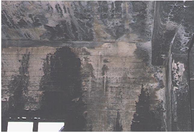
Foto 6.7: Nasser Übergang Wand / Zentraldach
