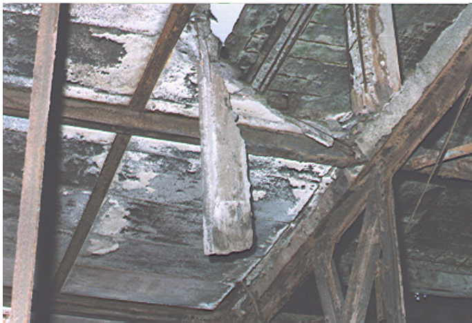
Foto 4.11: Durchbruch in Dach
