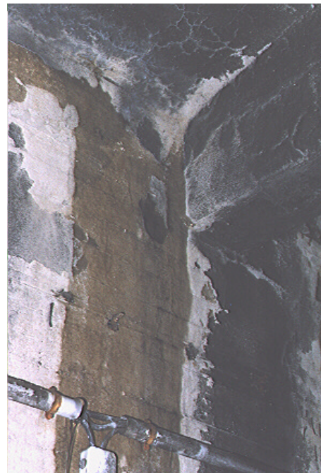
Foto 6.6: Feuchtigkeitstritt an Unterzug
