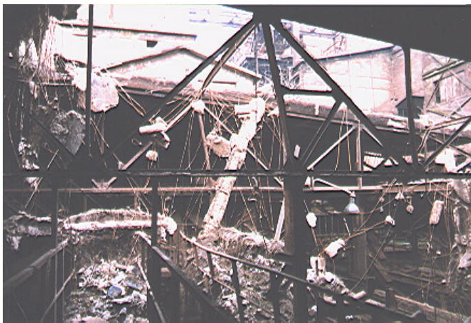
Foto 4.8: Innenansicht eingestürzte Lichthaube
