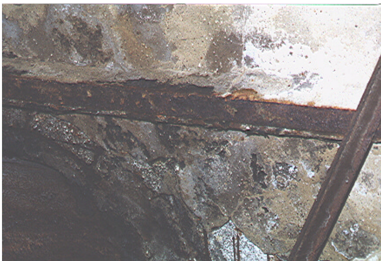
Foto 1.5: Durchnässte Dachfläche mit stark korrodierten Stahlträgern
