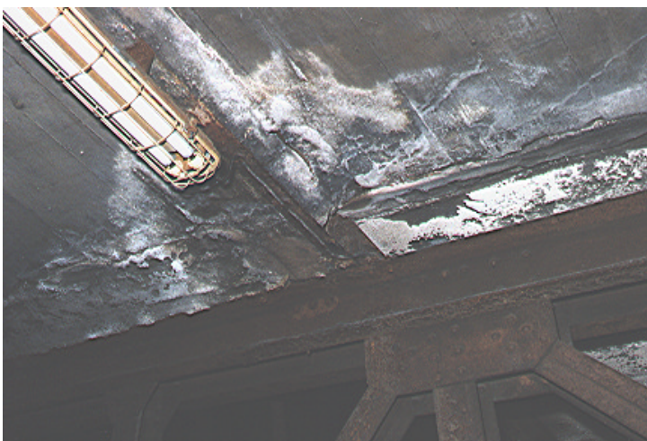
Foto 2.7: Durchfeuchtungen im Dachbereich
